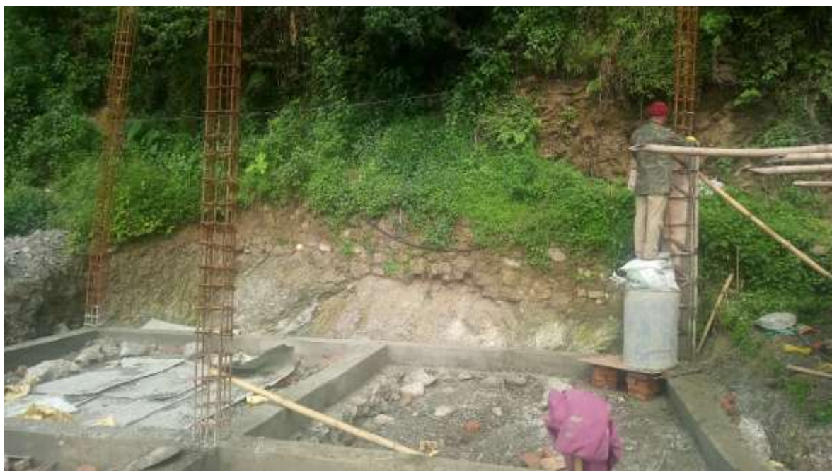
Fig: Construction Malpractice
